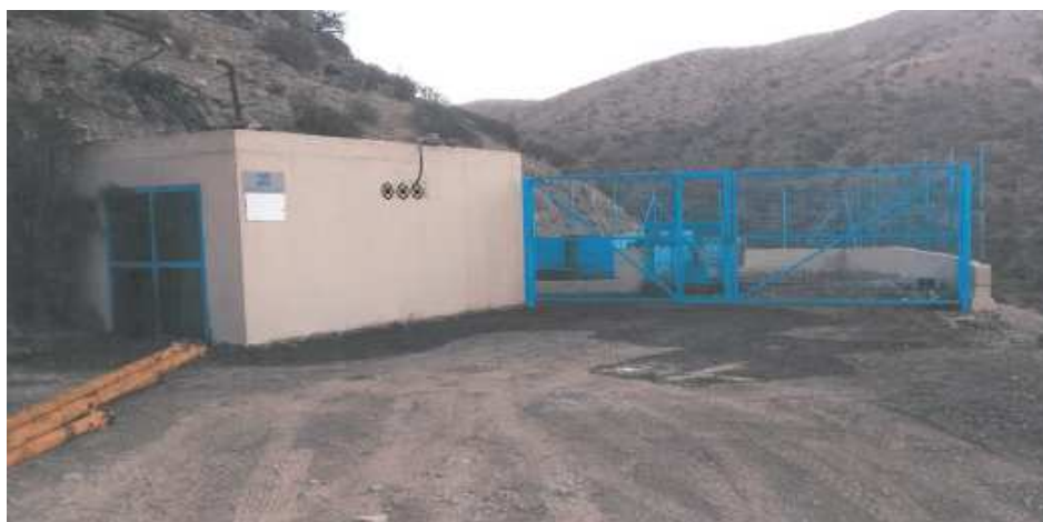
Fotografía del pozo de captación de agua
